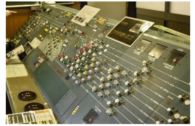
旧第 1 種継電連動装置表示盤
